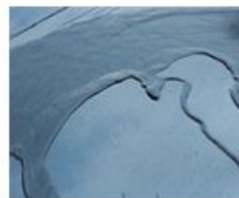
ホースなどで水をかけたときの漏水状態
